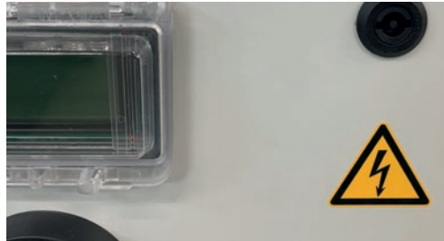
Abb. 2: Warnung vor elektrischer Spannung an der Steuerung
