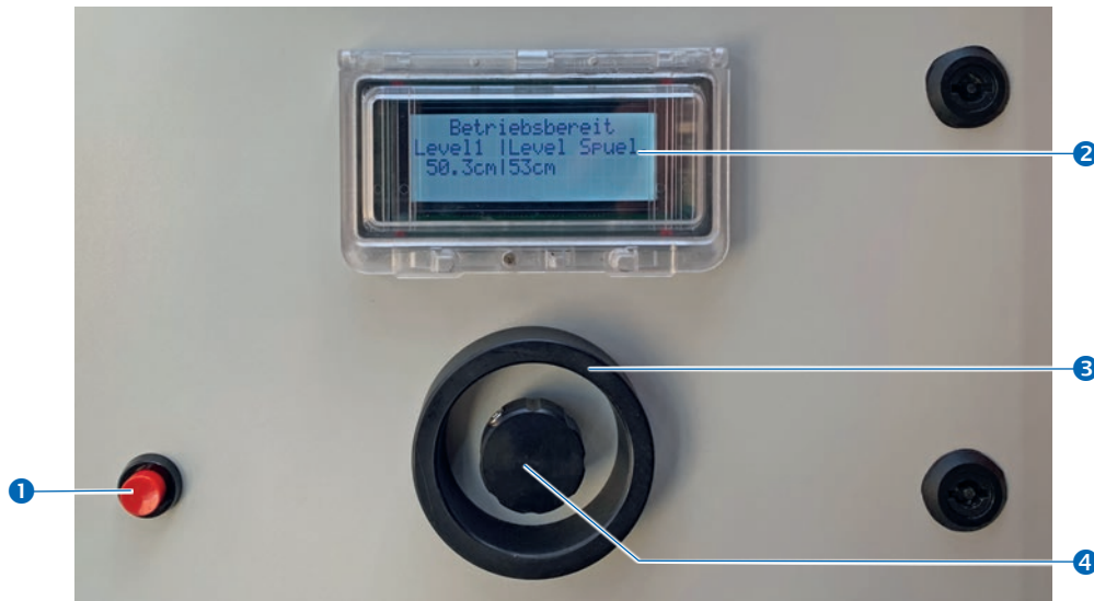
Abb. 17: Die Steuerung des Trommelfilters
