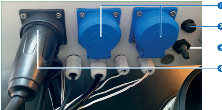
Abb. 10: Unterseite der Steuerung
